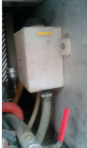
Imagen 42. Depósito de agua del sistema de cebado
